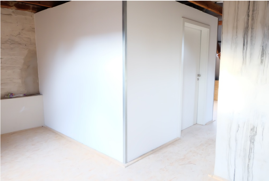
Abbildung 98 Wohnung Hi-E38, neu erstellte Lüftungszentrale im DG, Foto Unverzagt
