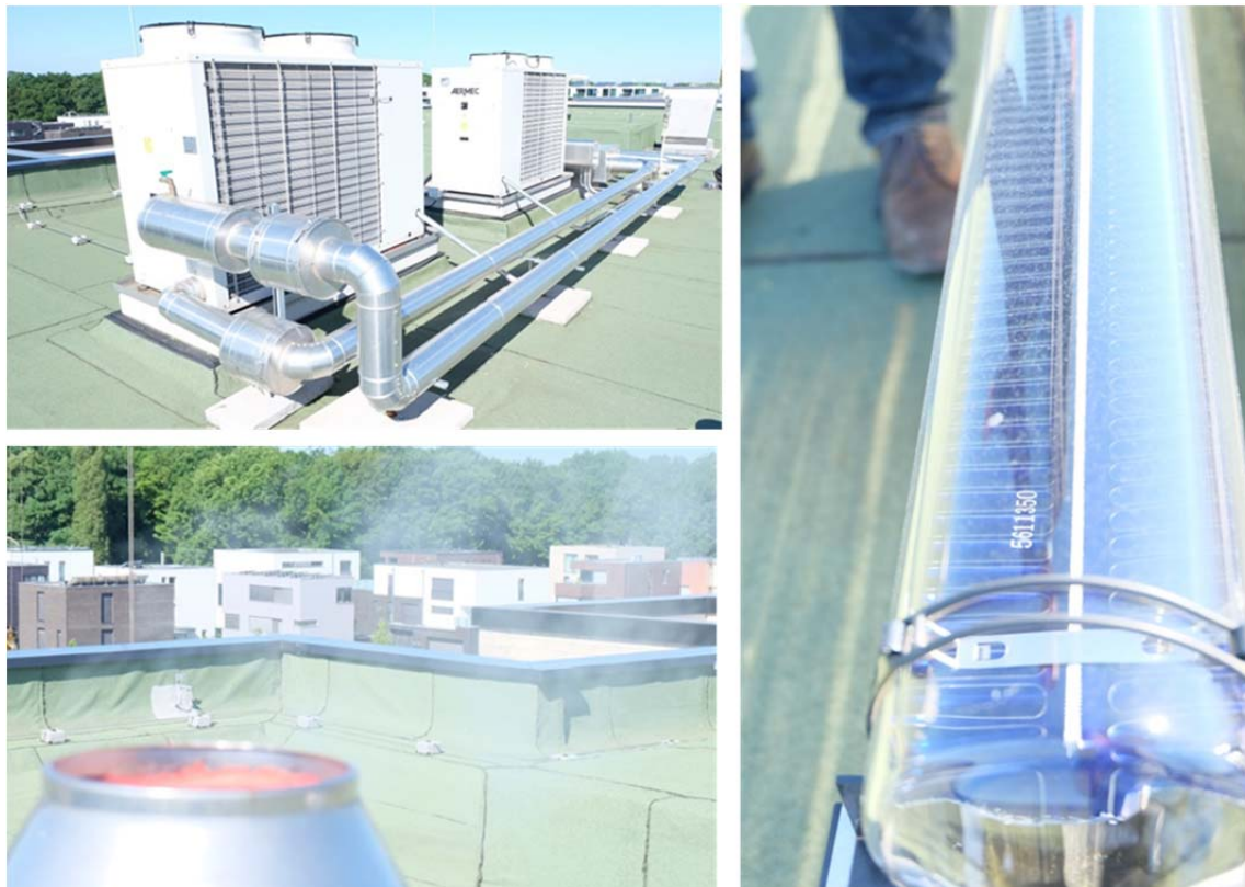
Abbildung 87 Auf dem Dach: Foto links unten: Abgase steigen aus dem Schornstein auf, Therme ist in Betrieb, Foto rechts: Aperturfläche der Vakuumkollektoren ist waagrecht ausgerichtet, Abgleich mit Planung erforderlich, Foto rechts oben: Wärmepumpen
