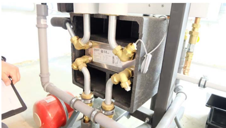
Abbildung 25 Wärmeübertrager Objekt H-H9-11 zur Trennung von Sekundärkreis und Kessel (Foto Unverzagt)
