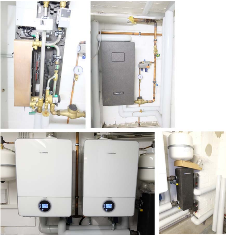
Abbildung 45 Heizungserneuerung BS-B20-22, Junkers-Gasthermen, unten rechts: hydraulische Weiche, Fotos oben: Frischwasserstation, Fotos: Unverzagt
