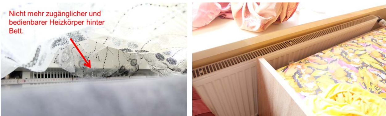
Abbildung 34 Ungünstige Möblierung vor Heizkörpern in Stöcken (Foto: Unverzagt)
