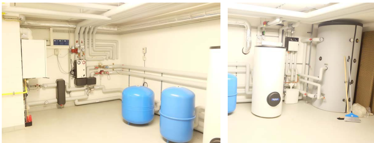
Abbildung 85 Heizzentrale Objekt H-HB24
