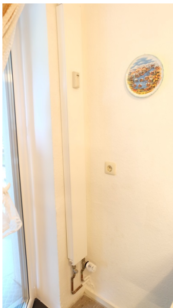
Abbildung 32 Heizkörper nach Balkontüreinbau in der Küche (Foto: Unverzagt)
