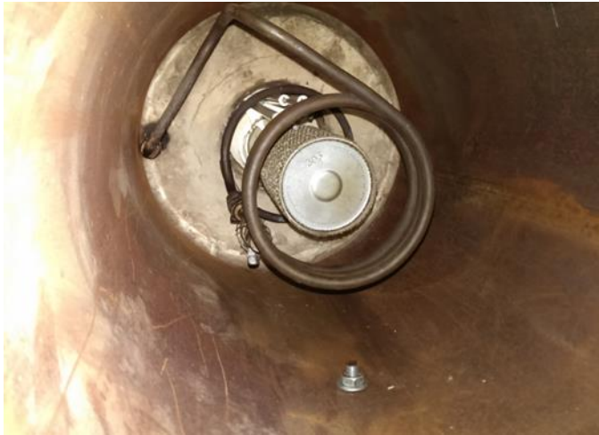
Bild 67: Innenansicht des Stahlrohres mit Wärmedämmung
