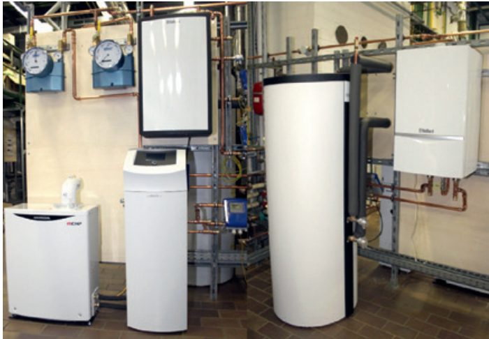
Gasgefeuertes Mikro-BHKW (1 kWel & 3 kWth) mit Pufferspeicher und Spitzenlastkessel
