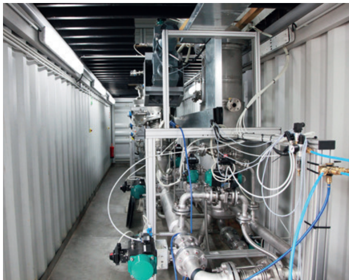
Multifunktionale Reaktoranlage im Pilotmaßstab
