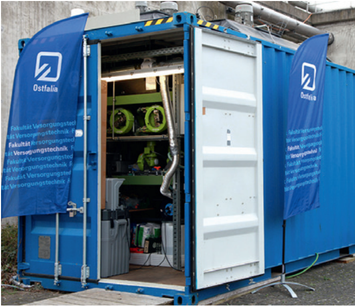
Versuchsanlagencontainer auf der Kläranlage Wolfenbüttel
