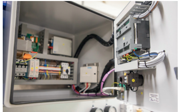
Steuerungsgeräte und Kommunikationstechnik
