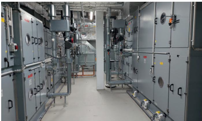
Raumlufttechnische Anlagen in der Technikzentrale des Klimalabors
