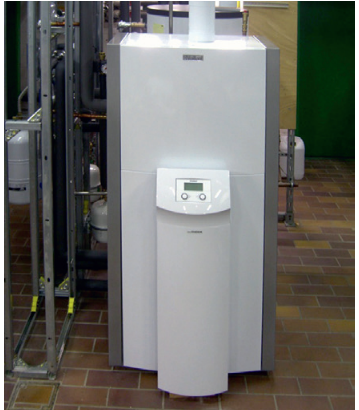
Zeolith-Gas-Wärmepumpe mit einer Heizleistung von 10 kW im Labor für Gas- und Verbrennungstechnik
