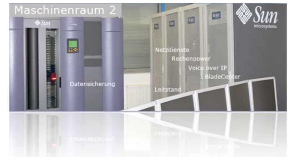
Maschinenraum 2 des Rechenzentrums
